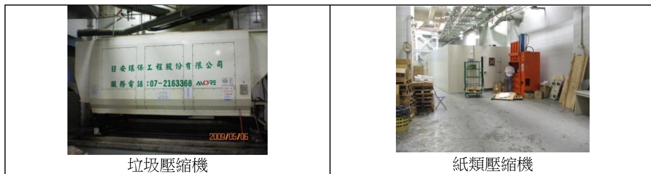
圖 12-17 垃圾壓縮設施
